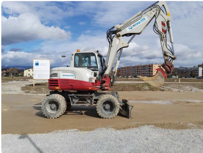
Začela se bo prva etapa gradnje nove soseke. (Foto: Radio Štajerski val)
